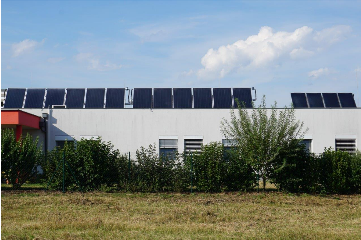
Photovoltaikanlage am Dach des Pflegekompetenzzentrums Drassburg (Foto: Spatzierer)
